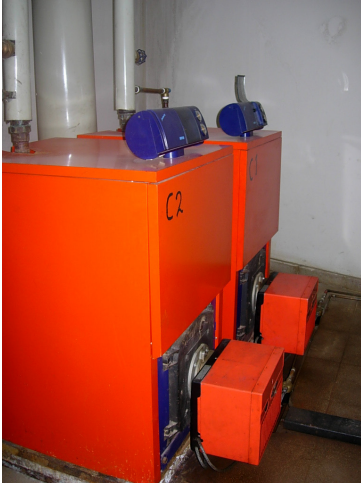
Figura 7.55. Caldera estándar a petróleo para calefacción por piso radiante instalada en edificio MOP, Puerto Montt.
