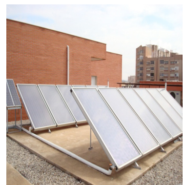
Figura 7.29. Instalación solar para edificio.
