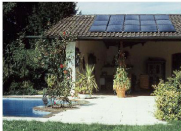
Figura 7.15. Instalación solar con colectores no vidriados para piscina.
