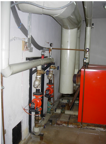
Figura 7.57. Distribución de agua caliente. Sistema de calefacción. Edificio MOP, Puerto Montt.
