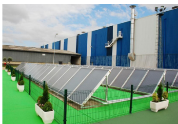
Figura 7.6. Instalación solar térmica para A.C.S.
