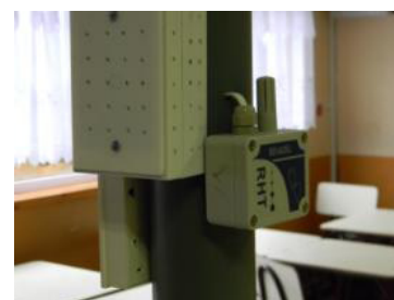
Figura 14. Monitoreo de concentración de CO 2 en aulas. Escuela Francisco Valdés Subercaseaux.
