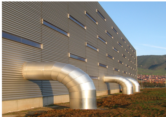
Figura 4.23. Tubos intercambiadores geotérmicos en Centro de Distribución y Logística FASA (zona 5C) (Guillermo Hevia arqto.)
