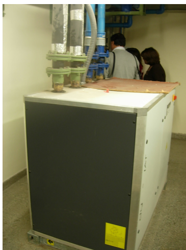
Figura 7.41. Bomba de Calor geotérmica marca Ciatesa instalada en edificio PDI Puerto Montt.
