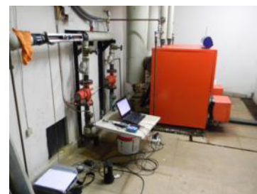
Figura 15. Mediciones de demanda y consumo de energía en sala de calderas. Edificio MOP Puerto Montt.
