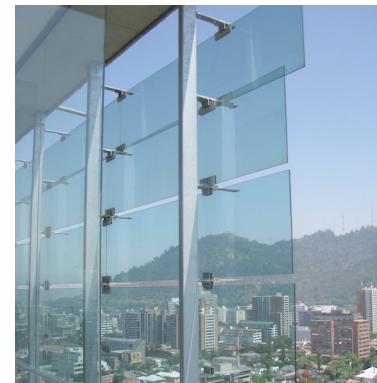
Figura 5.54. Protección solar a través de cristales con bajo factor solar. Edificio Duoc, Santiago.
