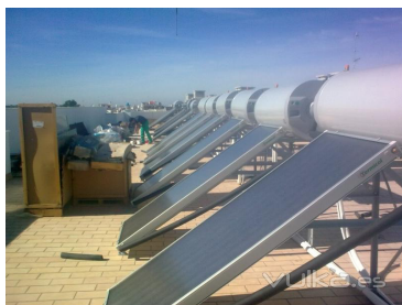
Figura 7.7. Instalación solar térmica de A.C.S. con acumulador para colegio, hotel o edificio.
