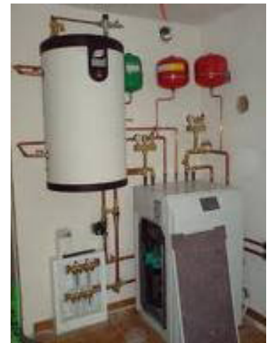
Figura 7.39. Bomba de Calor geotérmica con estanque acumulador.
