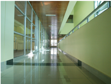
Figura 6.28. Acondicionamiento acústico en áreas comunes. Pasillo con alta reverberación, ausencia de material absorbente.
