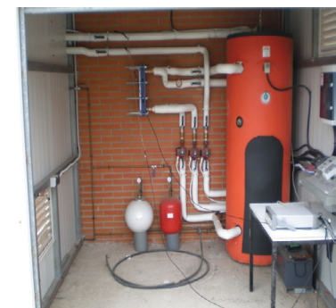
Figura 7.31. Monitorización instalación solar para abastecimiento A.C.S.
