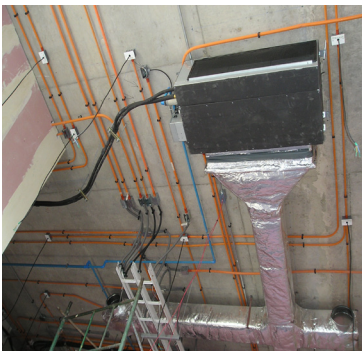
Figura 7.49. Unidad interior de tipo ducto de alta presión instalada.
