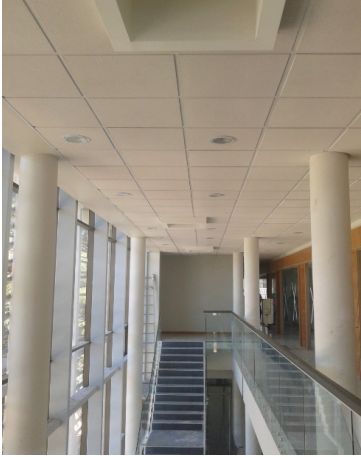
Figura 6.27. Acondicionamiento acústico en áreas comunes. Cielo absorbente.
