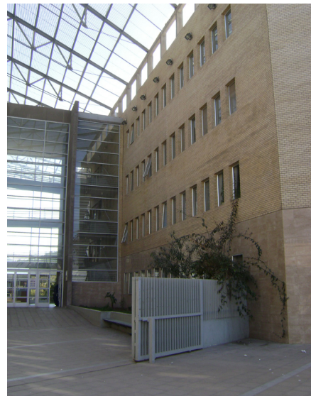
Figura 4.17. Muros con alta masa térmica en edificio MOP de Copiapó (zona 3 NVT). Se puede observar el predominio del lleno sobre el vano y las materialidades de hormigón y enchape de ladrillo, que logran una alta masa térmica.
